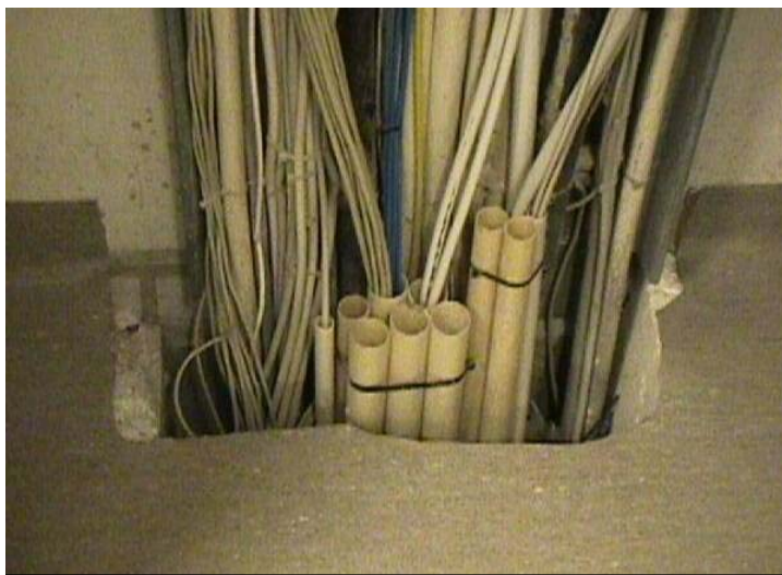
Bild 5: Vanliga plaströr fyller inte kraven för reserveringar.
